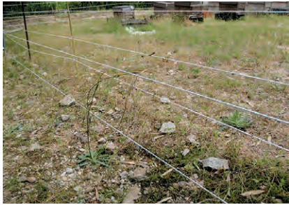
図25 ラインに雑草、蔓植物などが接触している例。電圧降下の原因になるので、下草の定期的な管理が欠かせない
