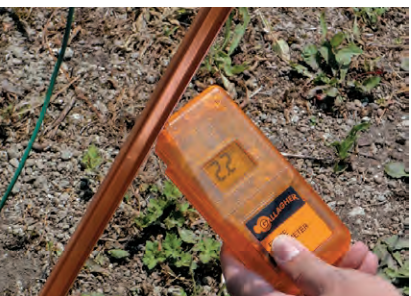
図14 アース棒の設置が不適切で2200Vが流出している
