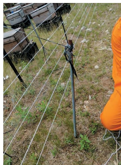
図23 金属製のポール(支柱)が隣接していると、強風などでラインが接触した時に漏電がおきるので、不要なポールはすべて撤去しておくことが望ましい
