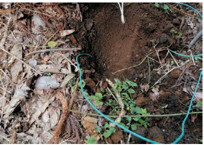
図15 アース棒が完全に地中に埋められた良い例
