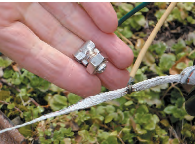
図37 パワーユニットから本線への接続が不適切な例。スパークが発生しラインの損耗につながる。写真のような専用の接続器具を用いる必要がある
